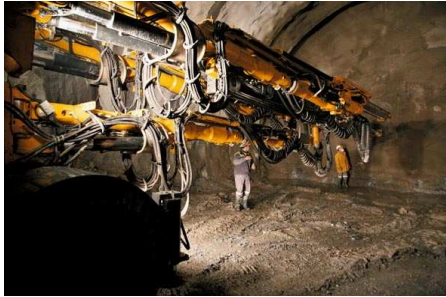
10. Robot pour la foration des trous pour la mise en place des explosifs au fond de la descenderie de La Praz (achevée en janvier 2009)
