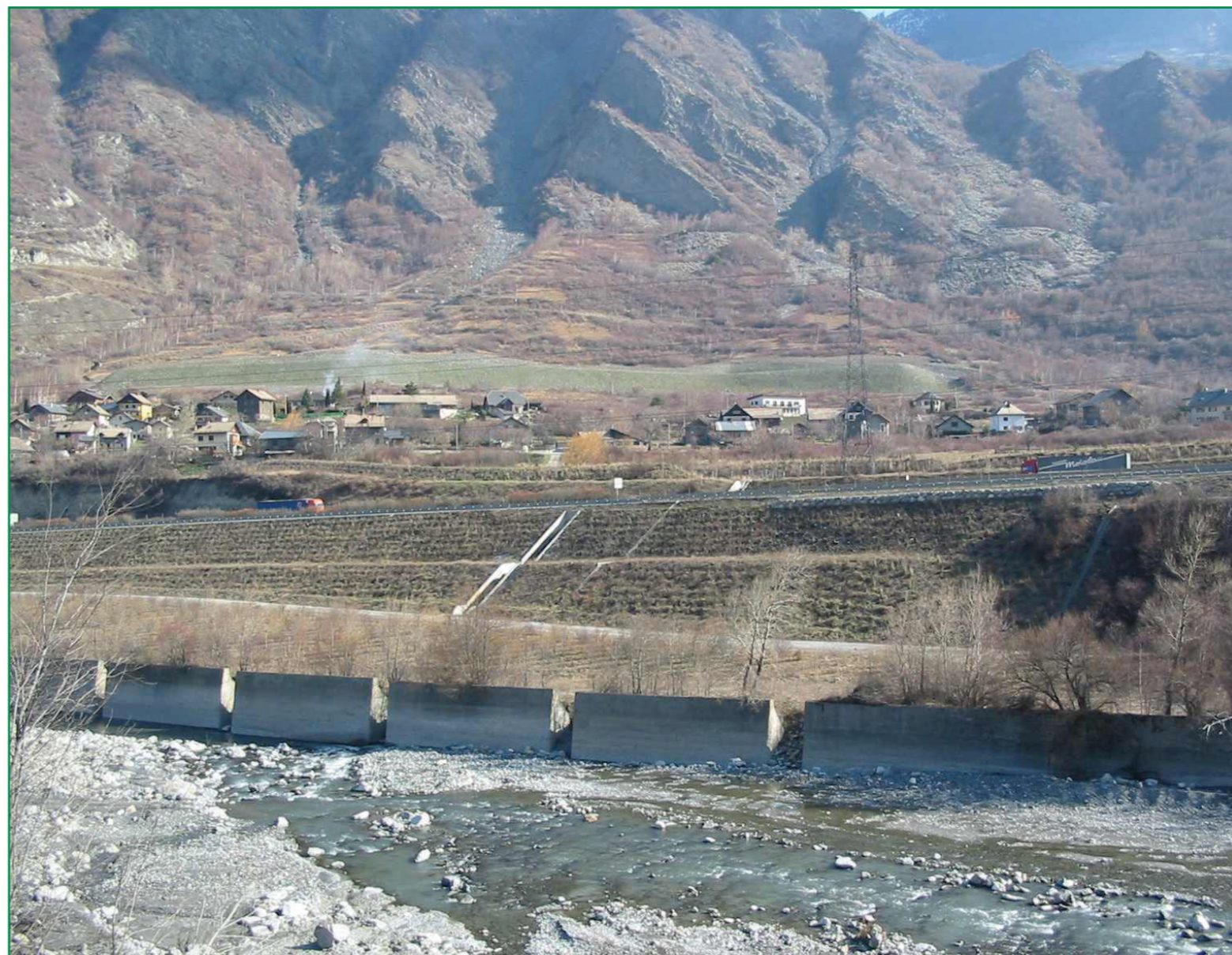
Dispositif de mur crénelé au droit de Sous-Villard-Clément.
