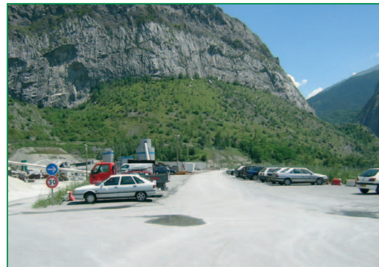
Falaise abrupte du Pas du Roc soumise à des risques de chute de blocs (Scetauroute 20/06/05).
