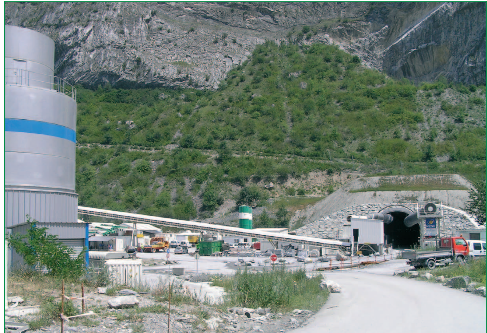
Bande transporteuse utilisée sur le site dans le cadre des travaux de la descenderie (Scetauroute 21/06/05).
