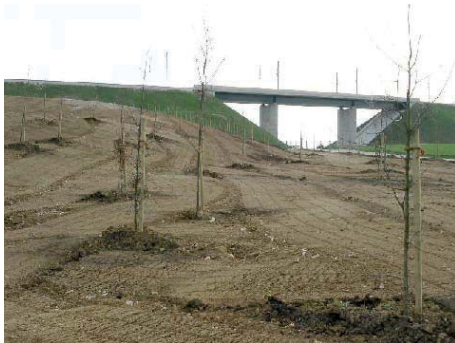
Plantation d'un bosquet sur modelé – insertion pont-rail – commune de Woimbe (55) – LGV Est - 2006
